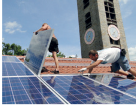
2011 – Die erste von drei Photovoltaikanlagen
